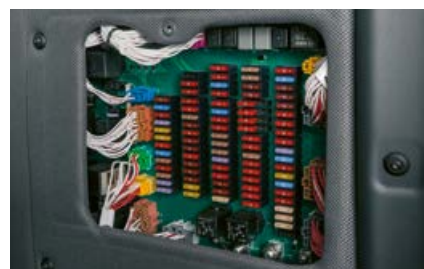
Základní centrální elektrika je uložena v chráněné přihrádce
